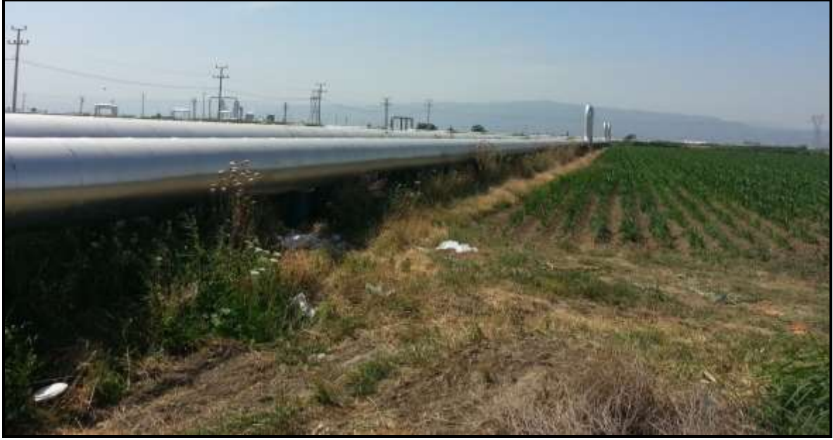
Şekil 94. Mevcut Borulama Sistemine Ait Görünüm
