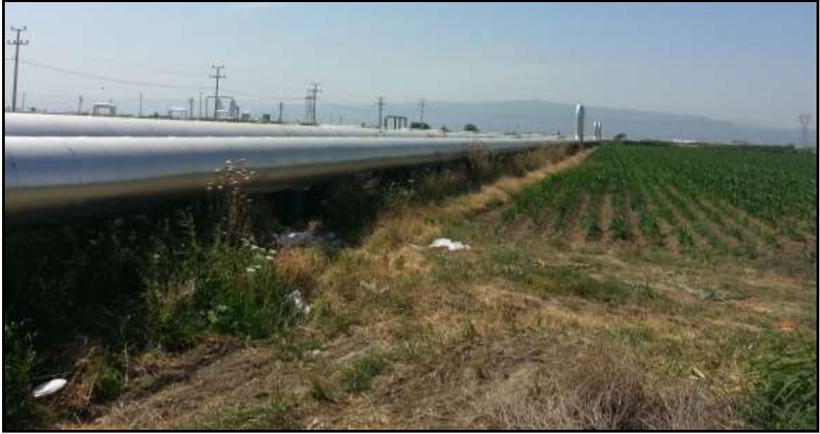
Şekil 95. Mevcut Borulama Sistemine Ait Görünüm
